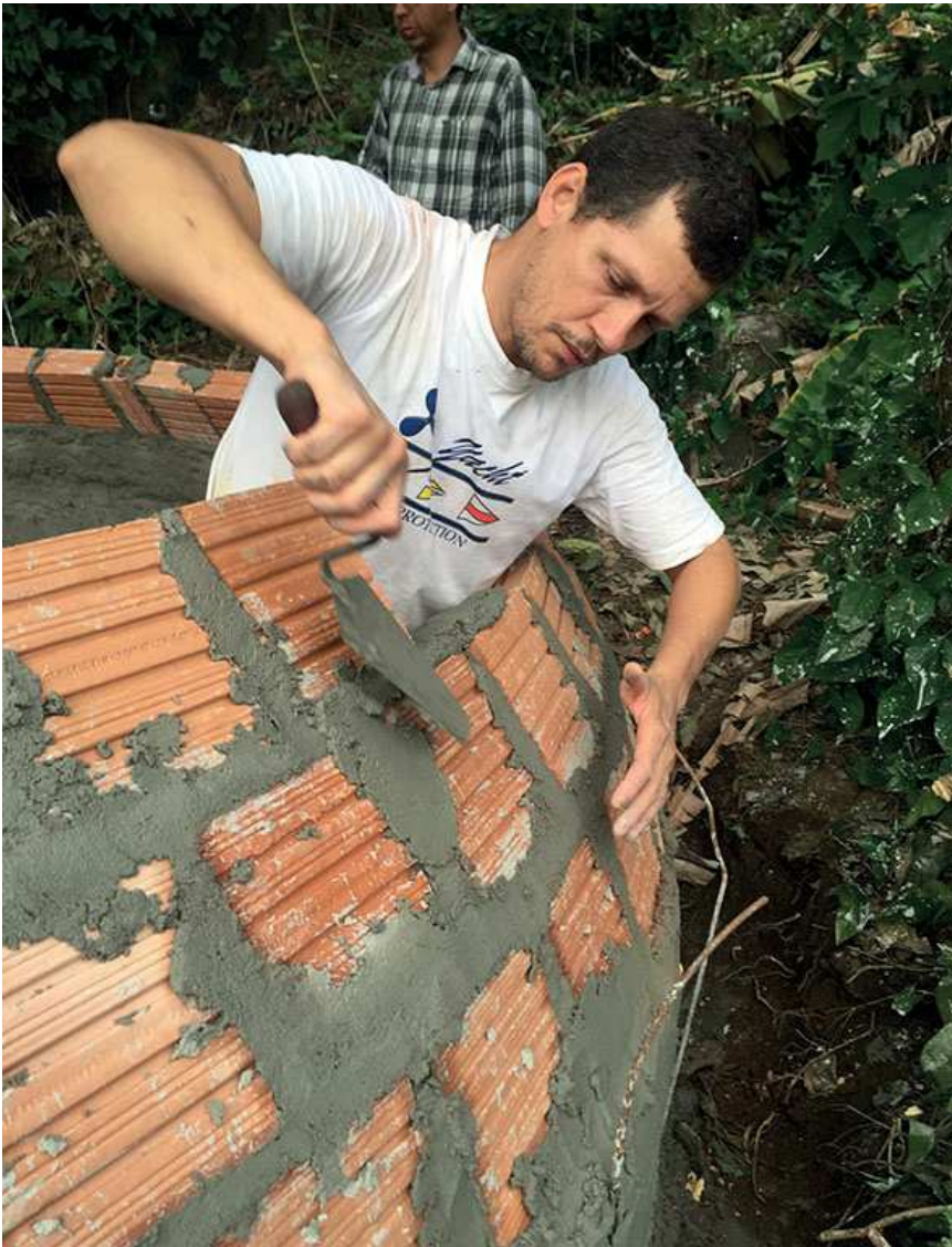
Construção do biodigestor: na câmara fechada, não há entrada de oxigênio, o que favorece a proliferação de bactérias anaeróbicas, que digerem a matéria orgânica presente nos esgotos domésticos
