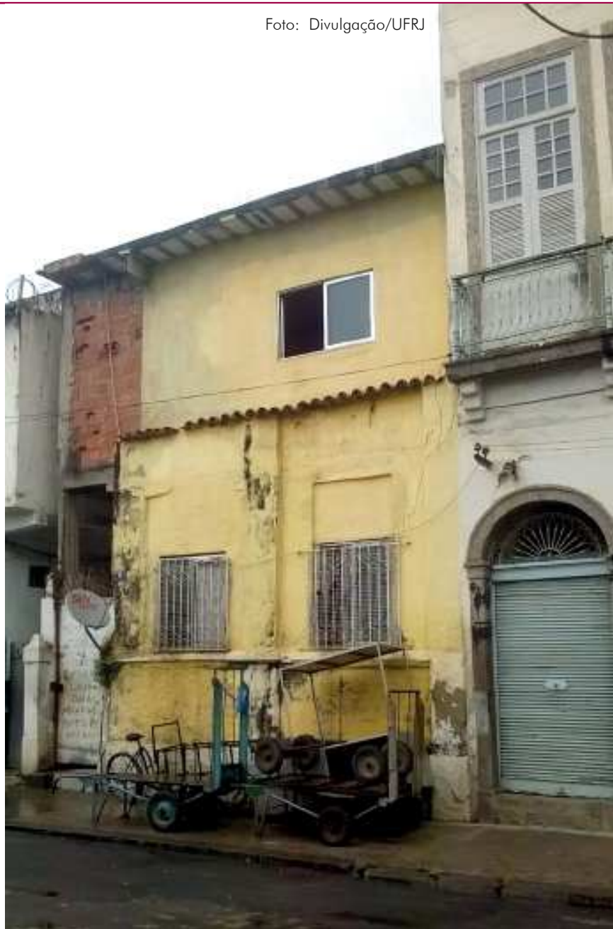
Em alguns cortiços, as condições de moradia são precárias, com pouca manutenção e cozinha e banheiro coletivos, que muitas vezes são utilizados por cerca de 20 pessoas
