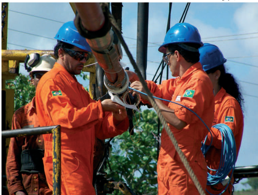
Investimentos crescem após a descoberta do pré-sal: sensores de fibra ótica são instalados em tubulações de plataforma de petróleo
